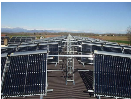
Рисунок 2 – Вакуумные солнечные коллекторы на крыше здания
